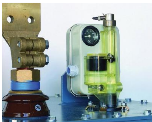
شکل ۸-۱۷- رله چندکاره ترانسفورماتور هرمتیک کنگره‌ای
